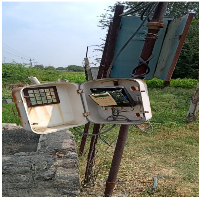
Fig: Pump Meter
